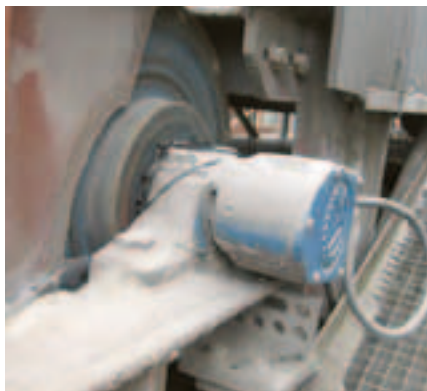
Feinanteile aus der Bauschutttaufbereitung setzen sich auch auf den Klemmkästen ab.
