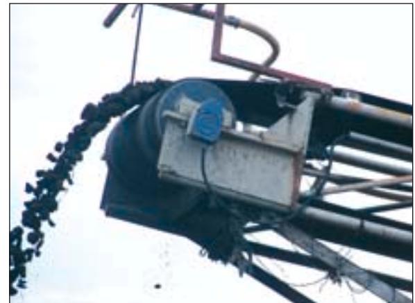
Abwurfband in der Schlackeverwertungsanlage in Ludwigshafen
