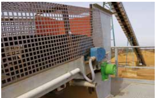
ZAHLREICHE Trommelmotoren (im Bild blau) treiben die Förderbänder der neuen Verladestation im Kieswerk Dorsfeld an.
